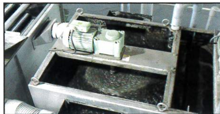
凝集混和タンク
